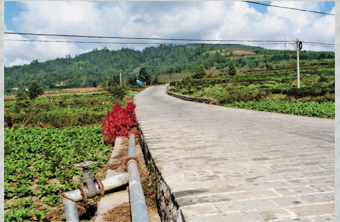
腾冲县马站乡兴华社区公路和自来水管
